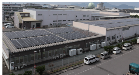
▲バンダイナムコクラフト（上）とハート（下）の生産拠点に設置された太陽光発電設備
