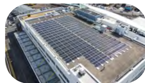
バンダイホビーセンターの太陽 光発電設備
